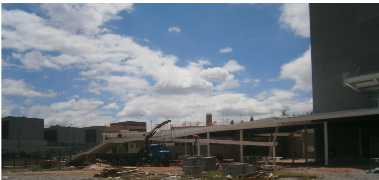
Figura 03: Detalhe da construção de Laje entre Blocos H e I que receberá a futura Passarela da UFABC. UFABC Unidade Tamanduatehy.
